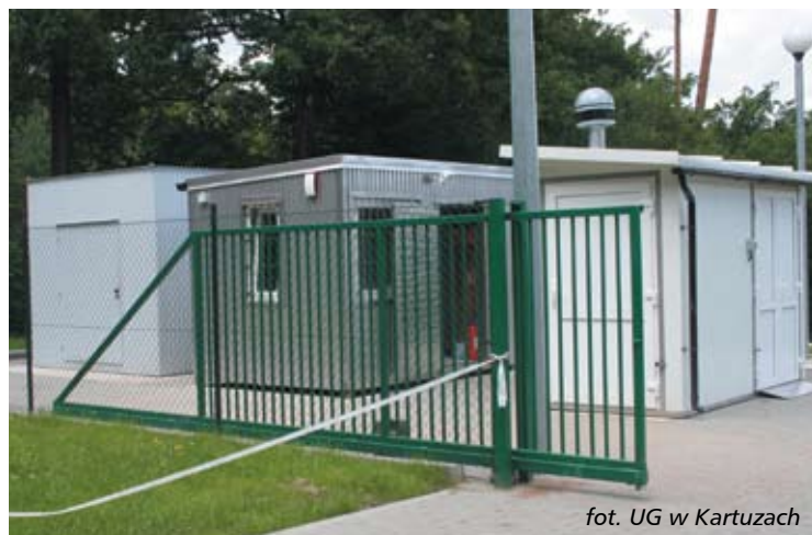
Nowa przepompownia ścieków w Dzierżążnie – wykonana w 2008 r. w ramach I etapu inwestycji.
